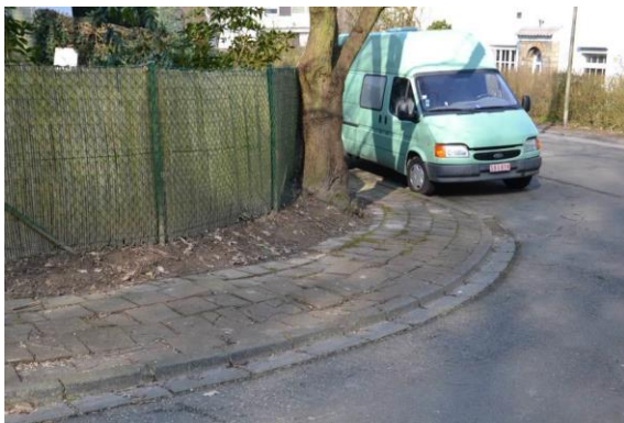
Foto 1: Voorbeeld van een trottoir in zeer slechte staat. Bron: Gemeentelijk Mobiliteitsplan – Fase 1 – Bestaande toestand en diagnose – BRAT – Oktober 2015 – p. 18
